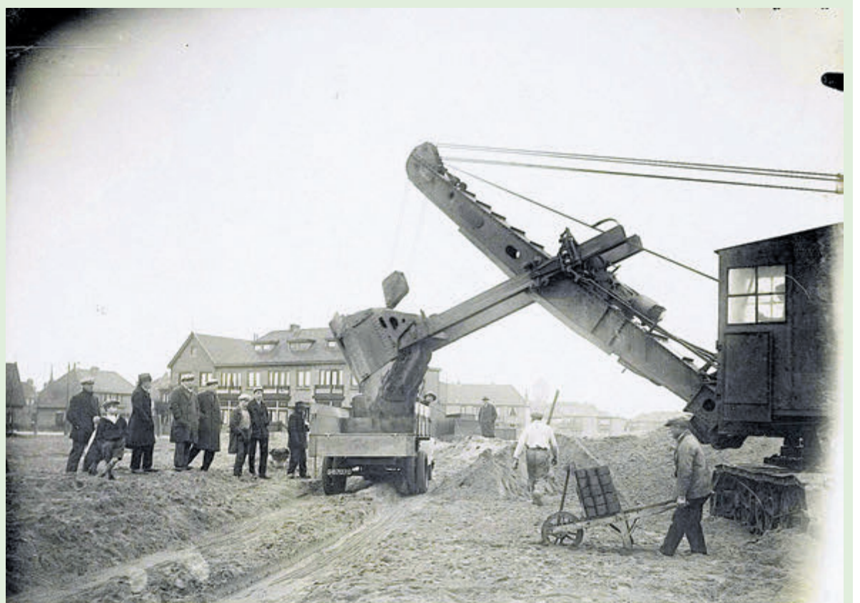
Afgraving van de Moerberg en omgeving, het gebied waar later Duinwijk werd gebouwd, ca. 1933-1935. Foto: Noord-Hollands Archief / Beeldcollectie van de gemeente Velsen, inv.no. 4726
